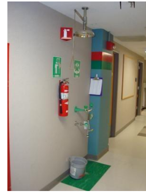
Duş ve göz yıkama ünitesi
