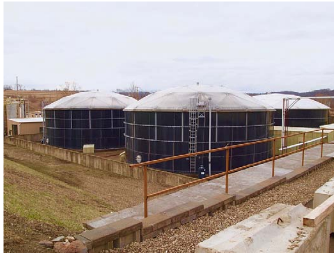
Şekil 6.30. Alıcı ortama deşarj edilmeden önce arıtmak üzere sızıntı suyunun bekletildiği dengeleme tankları
