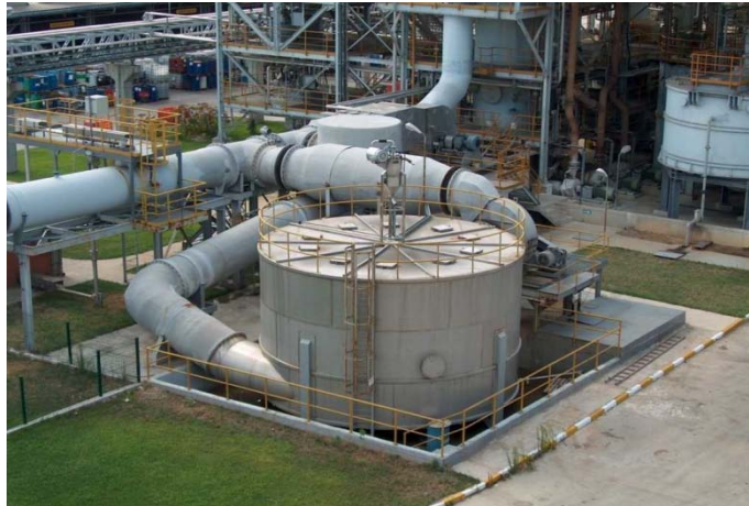
Şekil 29. İZAYDAŞ yakma tesisi dioksin ve furan kontrol ünitesi
