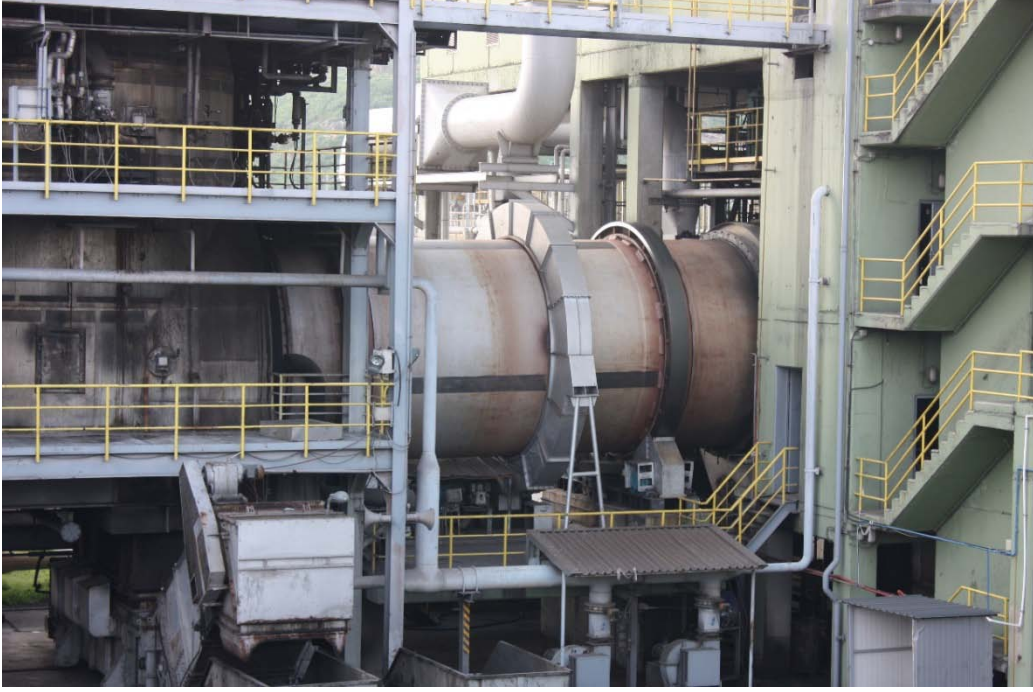
Şekil 10. Yakma Tesisi Döner Fırını (İZAYDAŞ Örneği)
