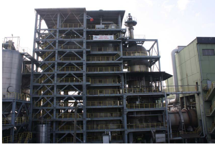
Şekil 12. Yakma Tesisi İkinci Yanma Odası (İZAYDAŞ Örneği)
