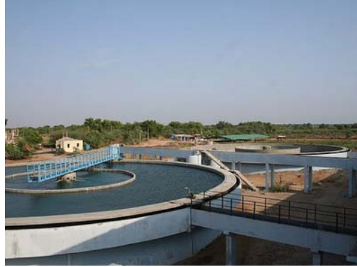
Şekil 25. Atıksu arıtma tesisi
