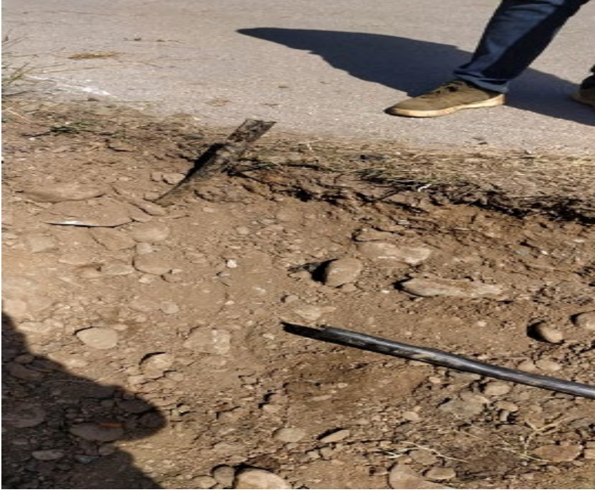
Resim-İnşaat yapımı çalışmaları sırasında kopan F/O kablo
