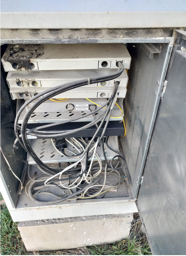
Resim-Alt yapı alıřmaları sırasında kopan F/O kablo saha dolabı
