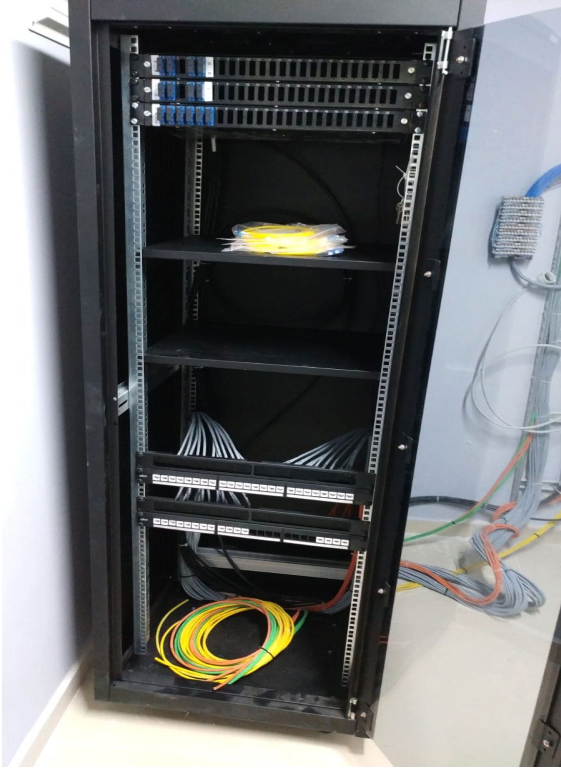
Resim-Sistem odası F/O data kabloları sonlandırma kabini
