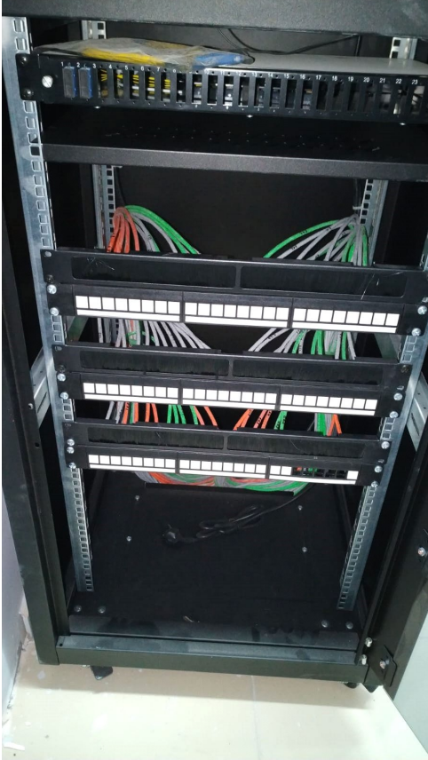
Resim-Sistem odası UTP-CAT-6 data kabloları sonlandırma kabini
